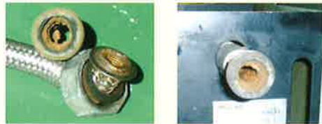
配管内の閉塞現象
